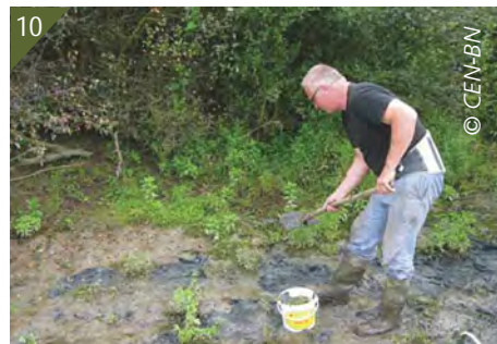
9 - Travaux de comblement du bras mort : bras mort entièrement comblé. 10 - Etrépage manuel.
