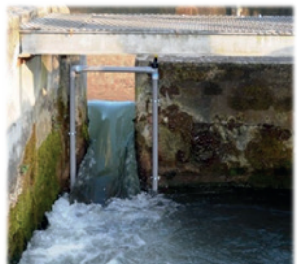
Cadre de détection installé dans un obstacle ©FD62
