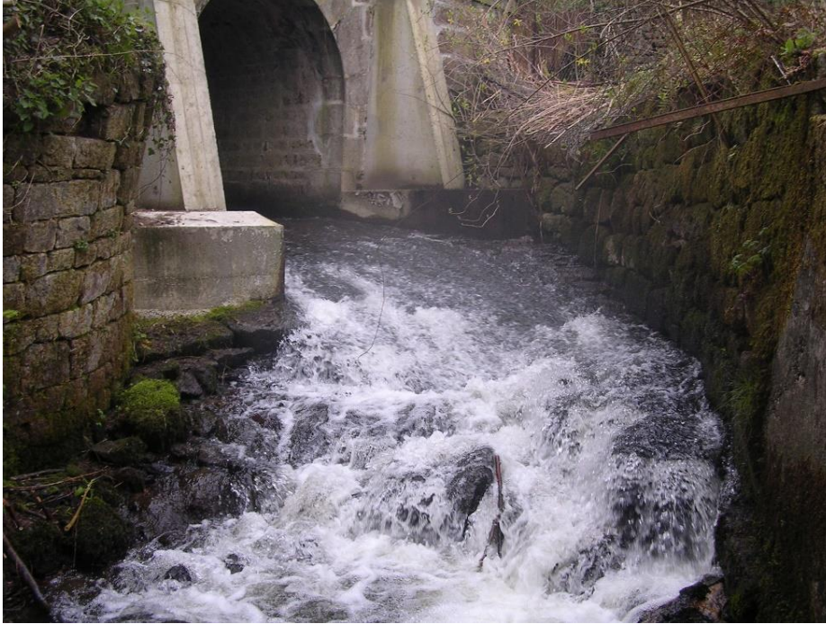
Figure 5 : Chute de 2.40 m en aval du pont RD 20, 2012.
