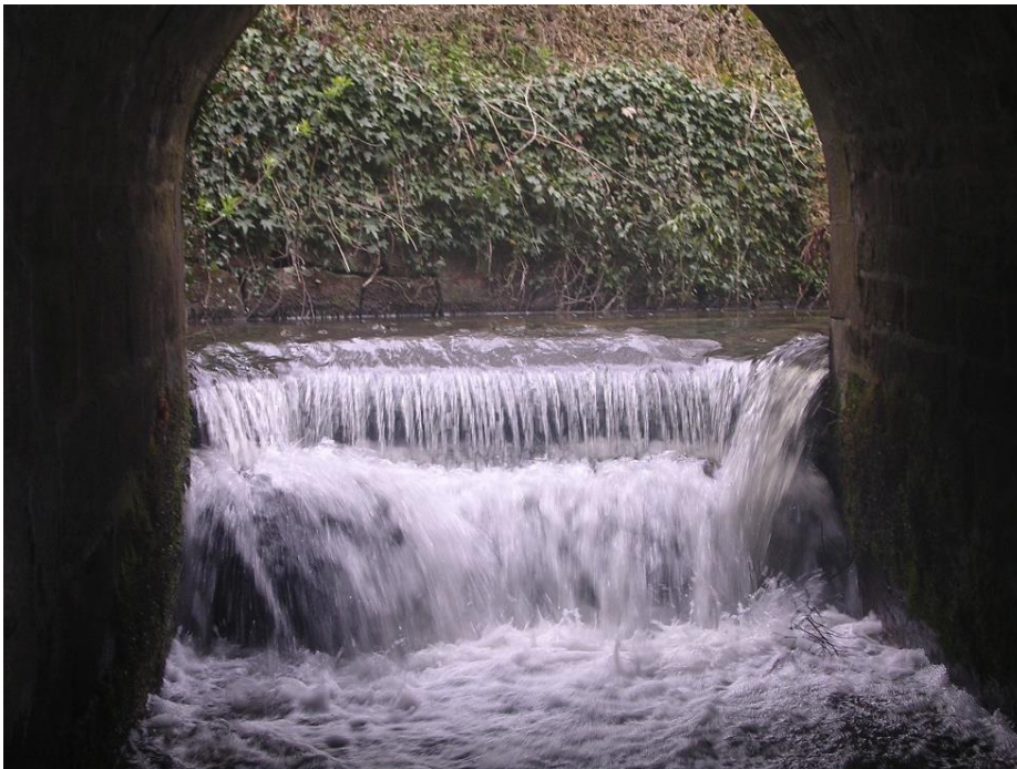
Figure 6 : Chute de 0.9 m à l'entrée du pont RD 20, 2012.
