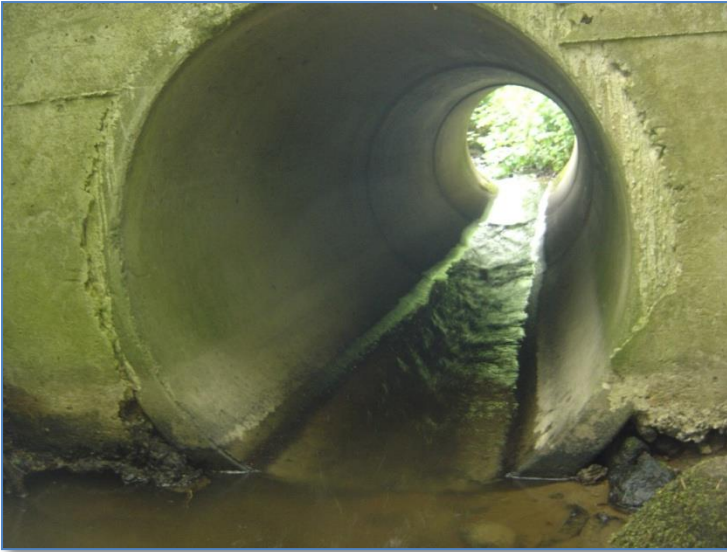
1. Avant aménagement. Buse difficilement franchissable
